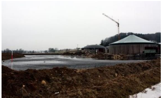
Abb. 6: Biogasanlage in Lehmingen: Freisetzung von rund 2000 m 3 Gülle, ein Teil gelangte in die Wörnitz [32]
