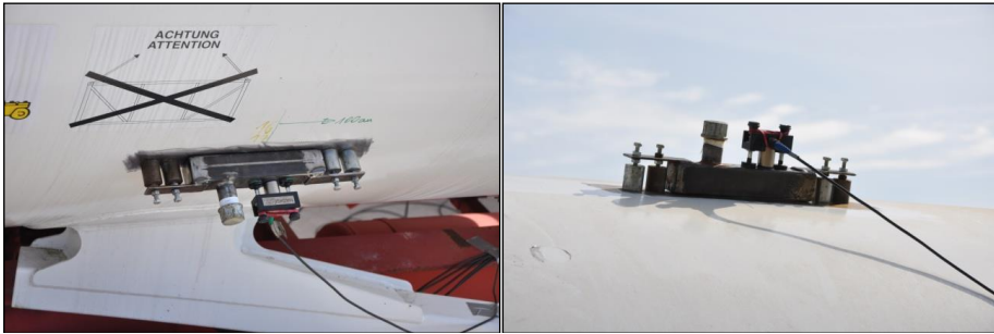
Abb. D-68: Korrosionsquellen KQ1 (links) und KQ2 (rechts)
