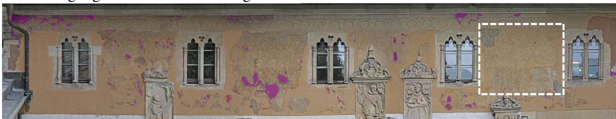
Bild 2. Von 2011 bis 2015 durchgeführte Verfestigungen an den Putzritzungen. Das Rechteck markiert das Zentralbild.
