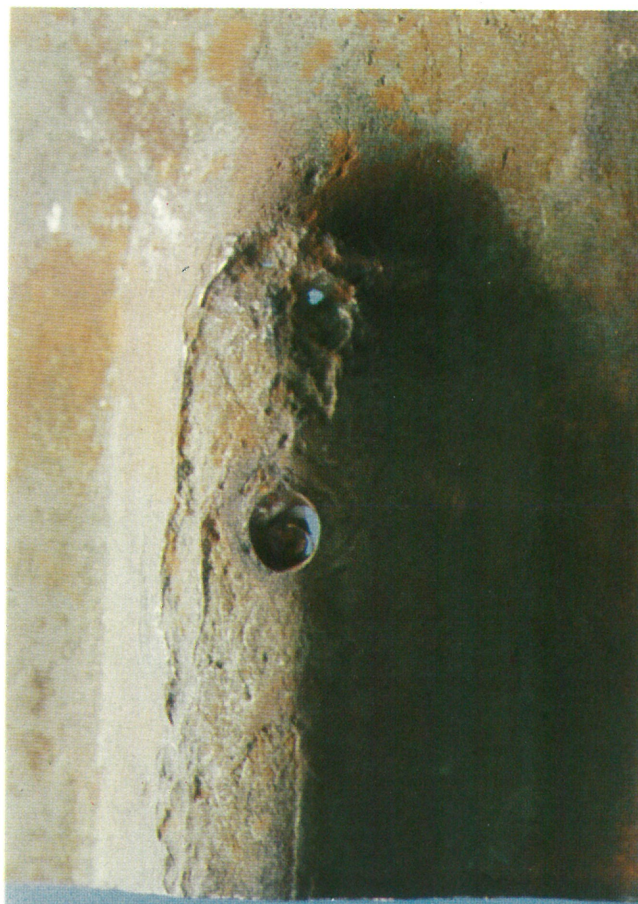
Abb. 3 Spaltkorrosion neben einer Punktschweißung eines Plattenheizkörpers mit Leckage
