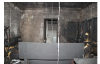
Abb. 6: Brandraum nach der Zündung
