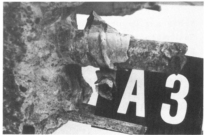
Bild 2.17 Aufgestemmter Querschnitt beim Probekörper A3 zur Bestimmung der Lage und des Korrosionszustandes der Bewehrung sowie des Verpreßzustandes der Hüllrohre
