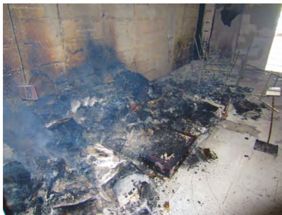
Abbildung C.54: Brandschutt Regalecke Versuch MFPA_Zimmer_004, Blick von der rückwärtigen Zugangstür, Aufnahme am Morgen nach dem Versuch. Die Kataloge aus den Regalen sind zum Großteil noch erhalten.
