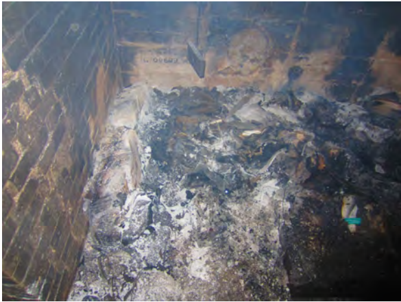
Abbildung C.57: MFPA_Zimmer_002: Brandschutt Regalecke, Blick von der rückseitigen Zugangstür, Aufnahme am Morgen nach dem Versuch. Die Kataloge aus den Regalen sind zum Großteil noch erhalten.
