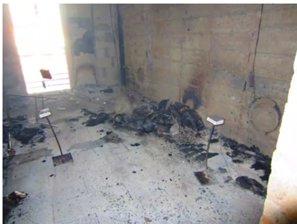
Abbildung C.53: MFPA_Zimmer_004: Brandschutt Regal 1, Blick von der rückseitigen Zugangstür, Aufnahme am Morgen nach dem Versuch. Die Kataloge aus Regal 1 sind zum Großteil noch erhalten.
