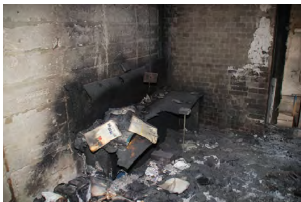
Abbildung C.55: MFPA_Zimmer_002: Brandschutt Sofa 1, Blick aus der Raummitte, Aufnahme am Morgen nach dem Versuch. Die Kataloge aus Regal 1 sind zum Großteil noch erhalten und liegen auf dem Boden und dem Sofa. Die Spanplatte von Sofa 1 ist ebenfalls noch fast vollflächig erhalten.
