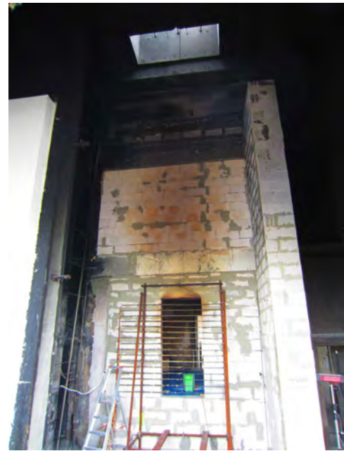
Abbildung 2.2: Prüfstand (Außenansicht Vorderseite)
