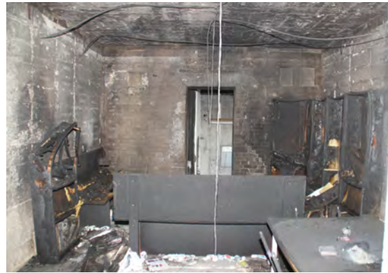
Abbildung C.58: Brandraum nach Versuch MFPA_Zimmer_005: Übersichtsaufnahme durch die Brandraumöffnung
