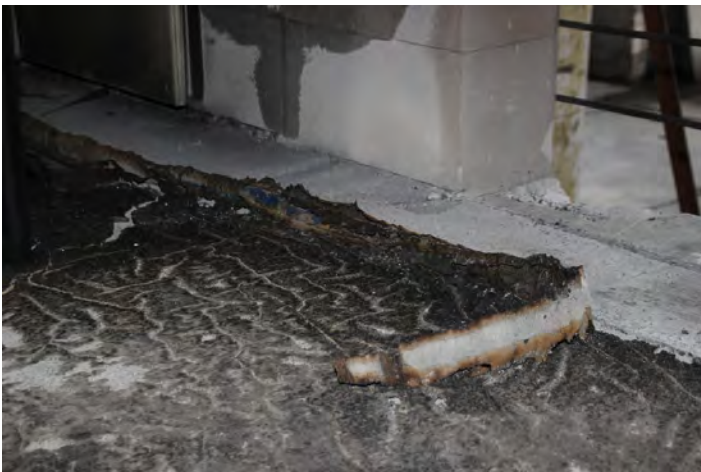
Abbildung C.63: MFPA_Zimmer_005: Brandrückstand Teppichboden vor der Brandraumöffnung
