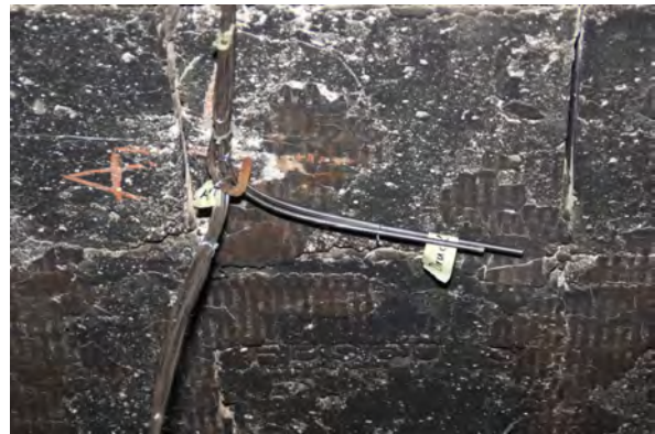
Abbildung C.41: Messstellen G2 und P1, Ende der Zuleitungen unter der Brandraumdecke
