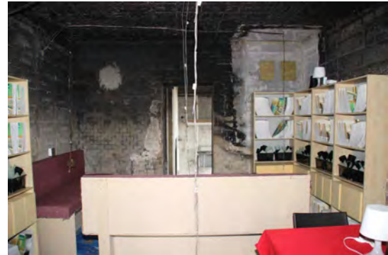
(b) Blick durch die Brandraumöffnung
