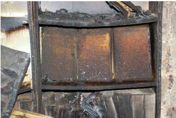
Abbildung C.69: MFPA_Zimmer_005: Brandrückstand PUR in Regal 5
