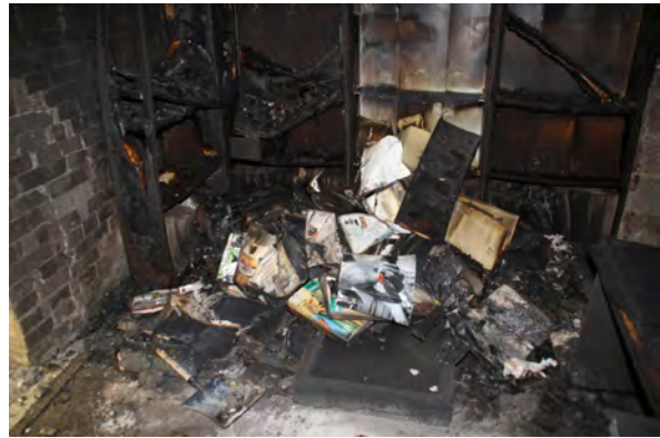
Abbildung C.68: MFPA_Zimmer_005: Brandschutt in der Regalecke
