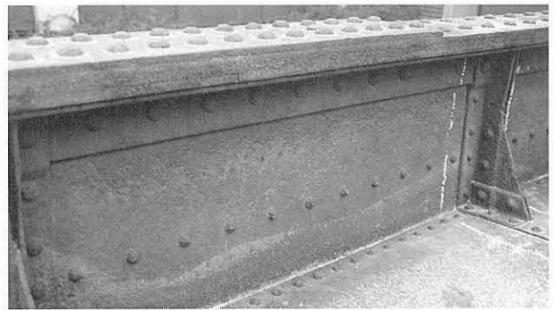
Bild 12: Rostnarbigkeit der Hauptträgerinnenseiten
