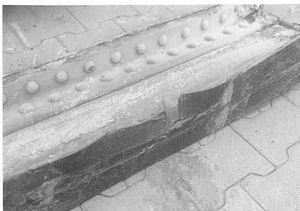
Bild 24: Ansicht des deformierten Längsträgers
