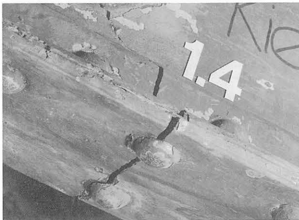
Bild 31: Ermüdungsriß im Untergurtbereich unterhalb der Regenrinnendurchführung
