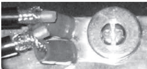
Abb. 14: Erdung über den Schirm eines zusätzlichen Antennenkabels
